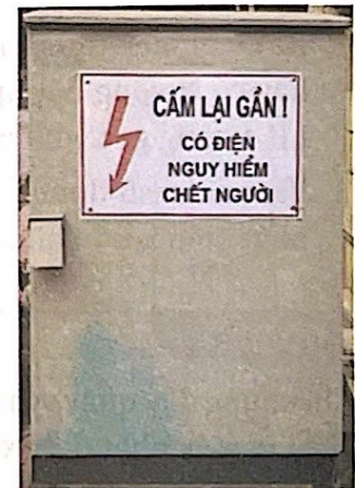
Hình 17.7. Biển cảnh báo an toàn điện
